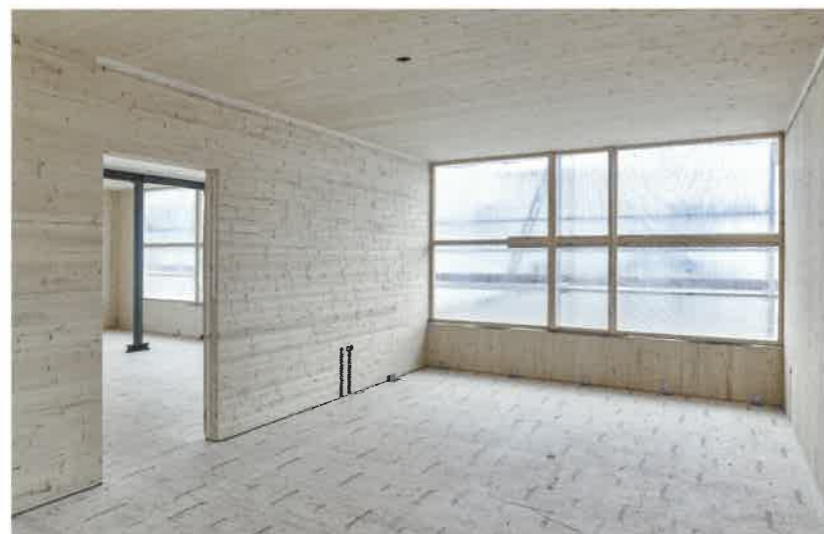
Die etwas andere Baustelle: So sauber geht es in einem entstehenden Holzbau zu.
